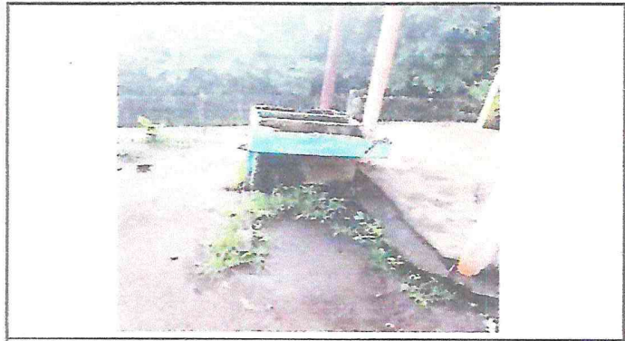
Foto 1: Pila en mal estado.
