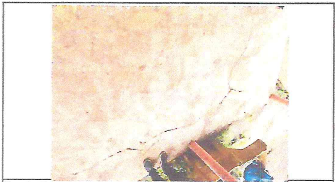
Foto 3: Torta de cemento en mal estado.
